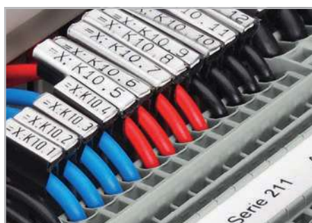
Маркировка проводников с помощью маркировочных манжет.
